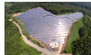
鳩山太陽光発電所
