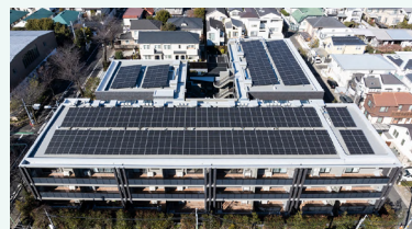
屋上一面に設置された太陽光パネル
