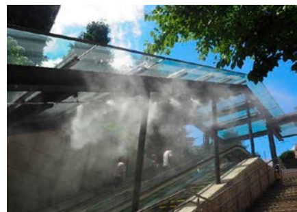
微細なミストで人やものを濡らすことなく周辺温度を3～5℃低下させる
