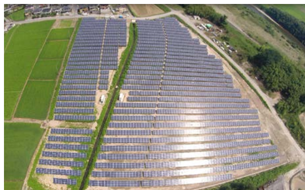
栃木西方太陽光発電所
