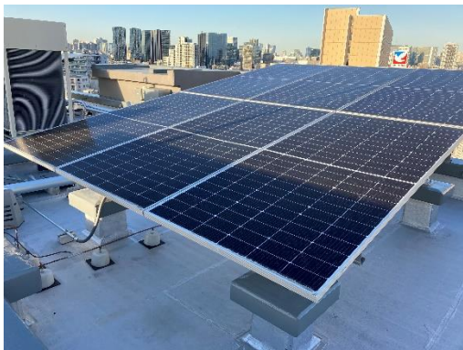
太陽光パネル
