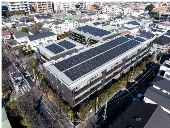
本物件屋上全面に設置された太陽光パネル
