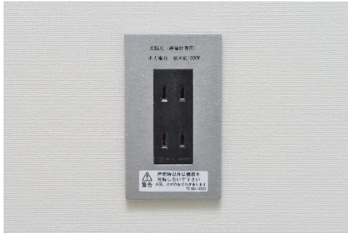
住戸内の非常用コンセント
