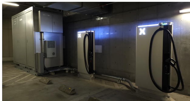
■2023 年 12 月 20 日オープン予定の EV チャージステーション
